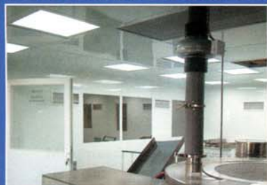
Воздухозаборные панели, подвесной потолок, встроенные светильники и воздухораспределители
